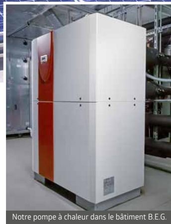
Notre pompe à chaleur dans le bâtiment B.E.G.
