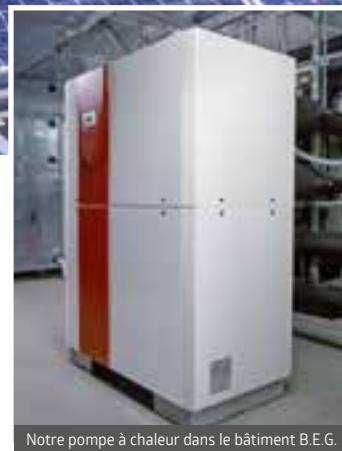
Notre pompe à chaleur dans le bâtiment B.E.G.
