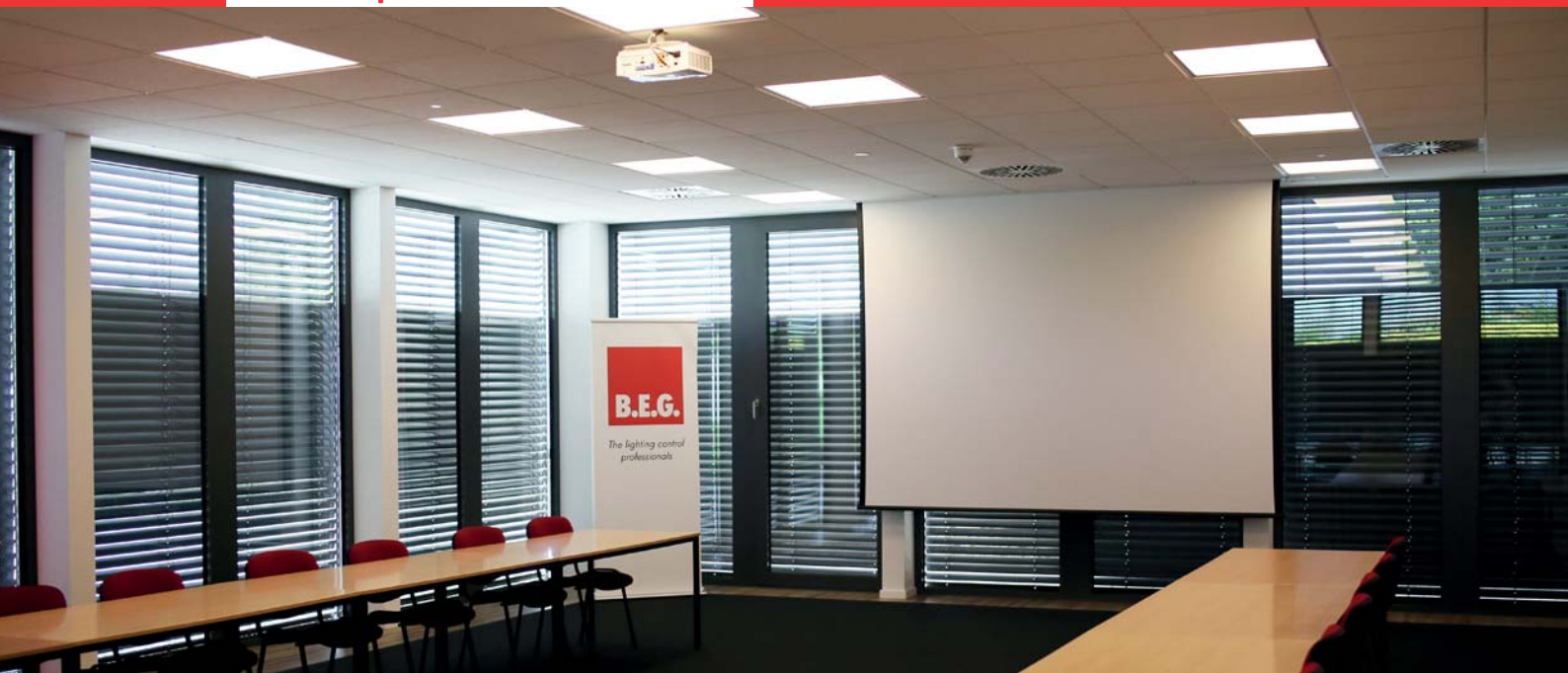
Éclairage biodynamique – zone commerciale - salle de formation avec PL1
