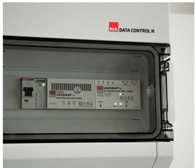
Zentrale Notleuchtenüberwachung – DATA CONTROL N
